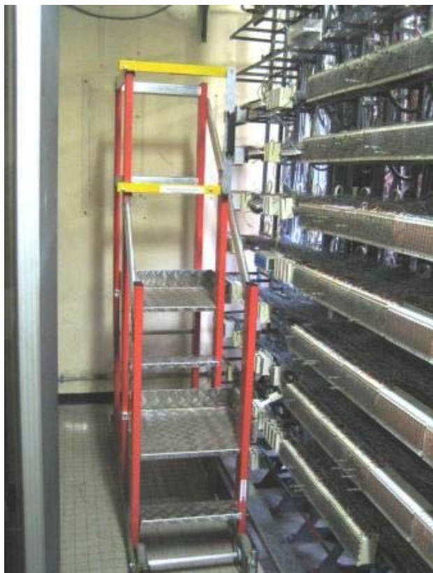
COTE HORIZONTAL DU REPARTITEUR
